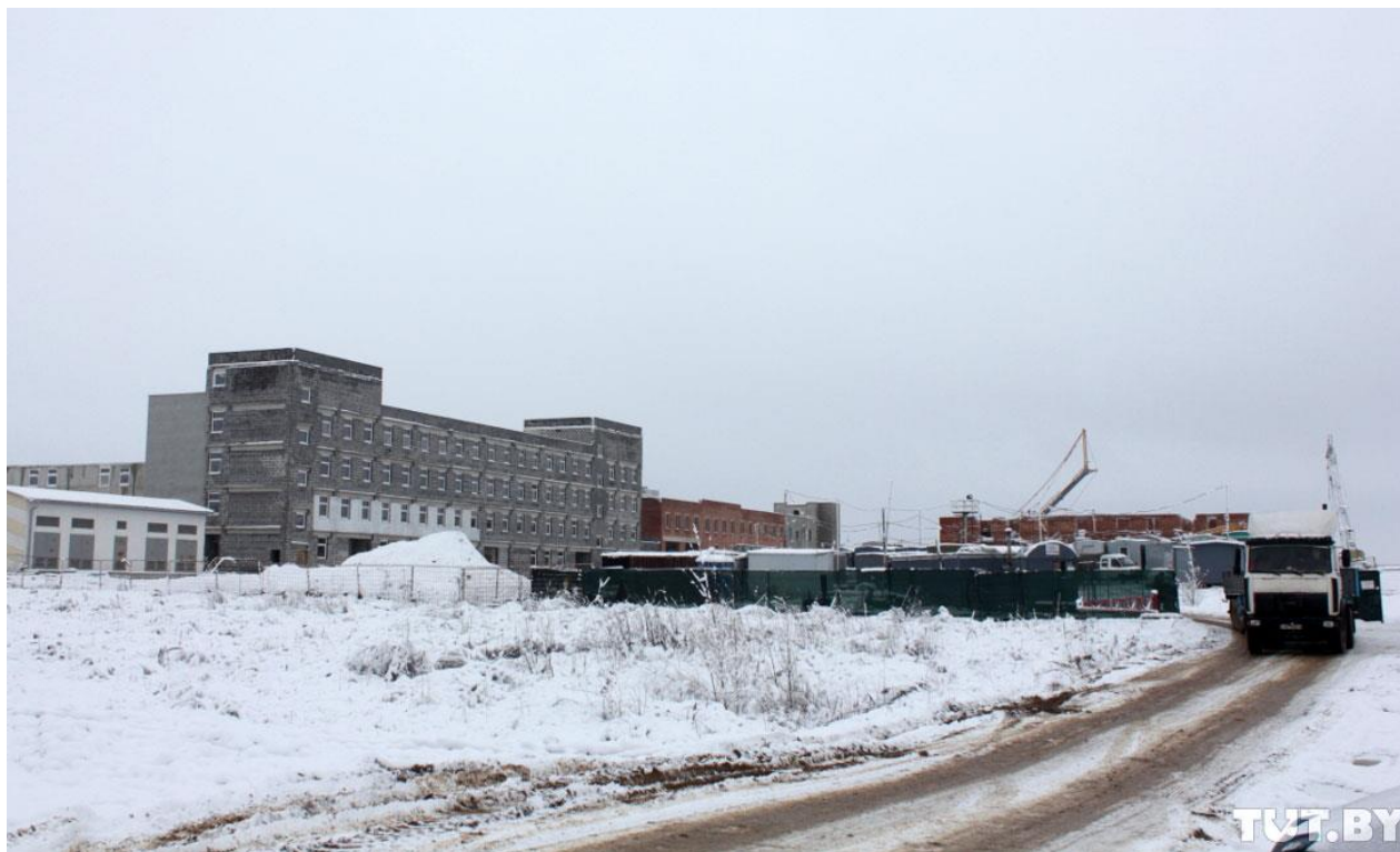
2017 год. Строительство комплекса зданий и сооружений следственного изолятора и республиканской общесоматической больницы». Фото: TUT.by
